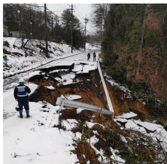
道路被害状況の調査
