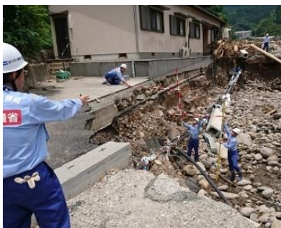
河川被害状況の調査
